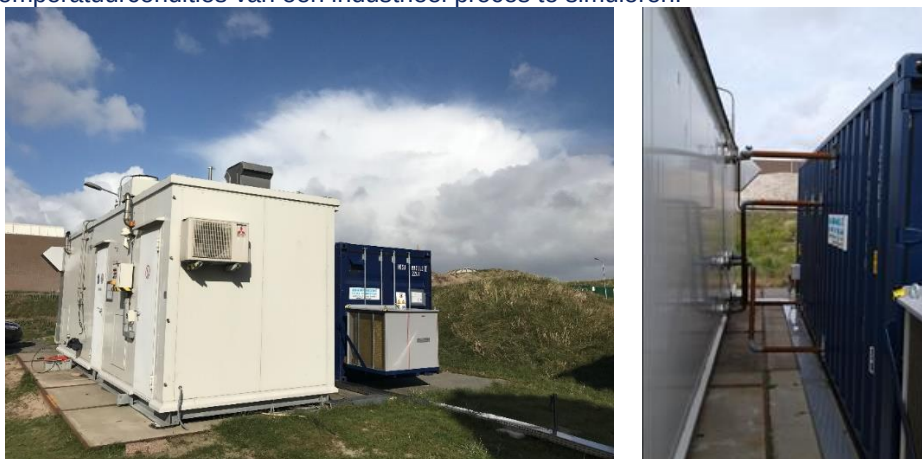
Figuur 4 Samenstel van warmtepomp en test rig
