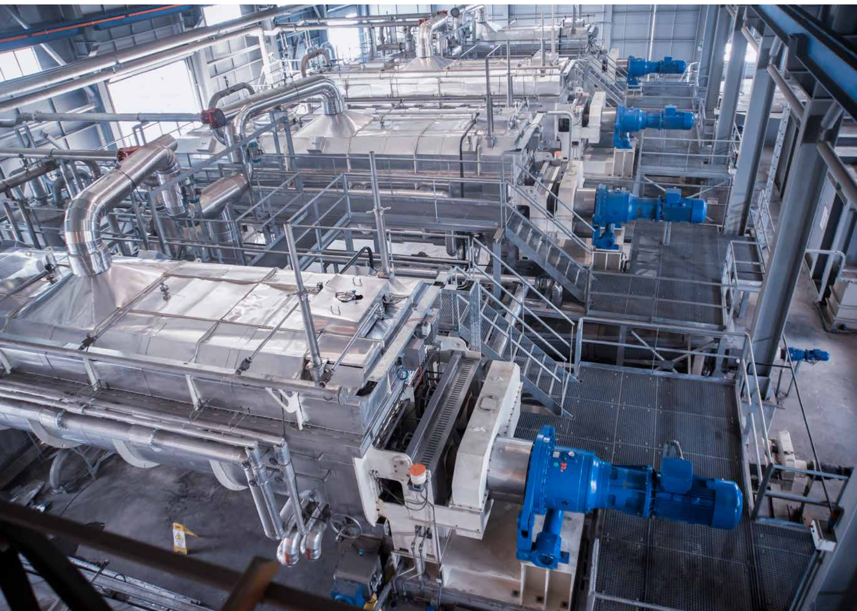
Peddeldrogers van Andritz Gouda in bedrijf op een rioolwaterzuiveringsinstallatie. (Foto: Andritz)
